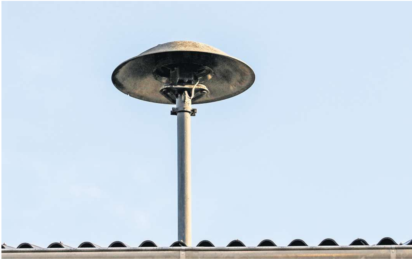
Mit den meist zentral in den Orten installierten Sirenen, wie dieser in Sindersfeld, können nicht nur Feuerwehren alarmiert, sondern auch Bürger vor Gefahren gewarnt werden.
