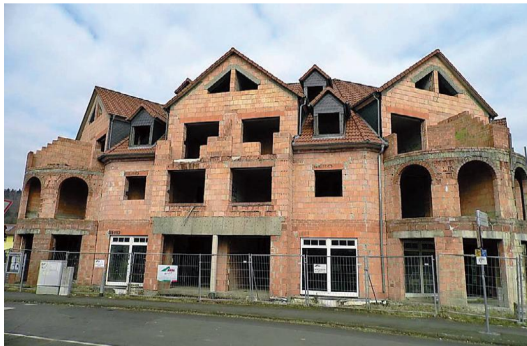
Die Bauruine in Gisselberg ist seit 17 Jahren ein Ärgernis für die Bewohner des Ortes. Trotz jüngster Versprechen tut sich momentan nichts auf der Baustelle. Archivfoto: Peter Gassner
