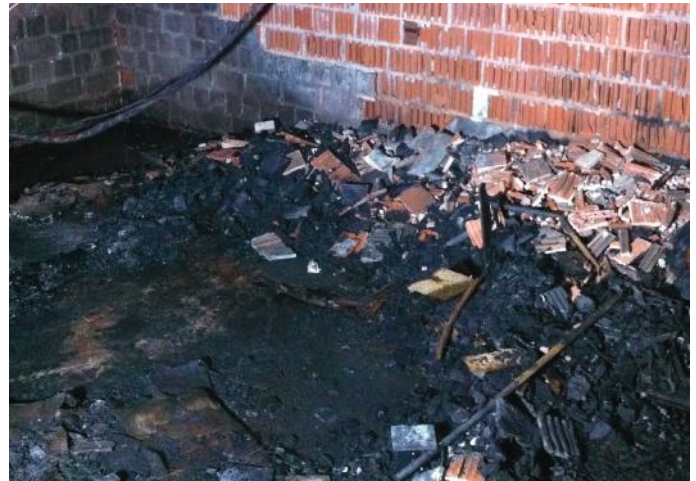
Brandausbruchstelle im Kellergeschoss.
