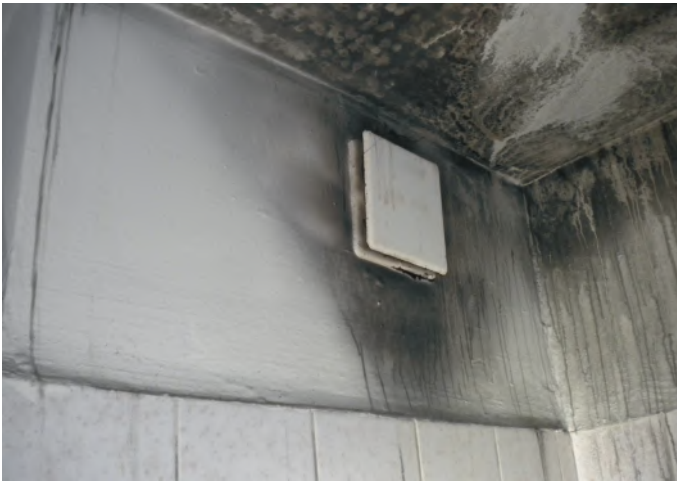
Brandrauchaustritt aus einer Lüftungsöffnung im 9. OG.
