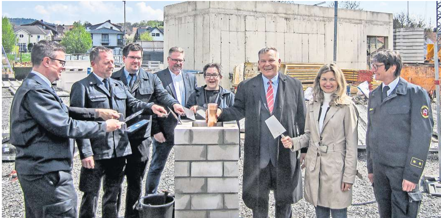
In den Grundstein für den Neubau der Feuerwehr Cappel legten Vertreterinnen und Vertreter von Stadt und Feuerwehr eine Zeitkapsel, in der unter anderem eine Ausgabe der Oberhessischen Presse enthalten ist.
